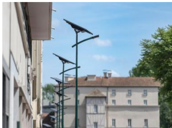
Ensembles solaires sur le quai de la République à Saint-Maurice - ©L.Schoenhentz - CD94
