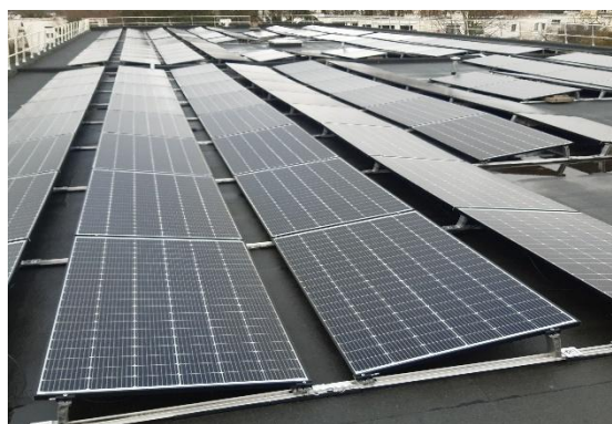
Panneaux solaires photovoltaïques du collège Albert Camus au Plessis-Tréville - ©CD94
